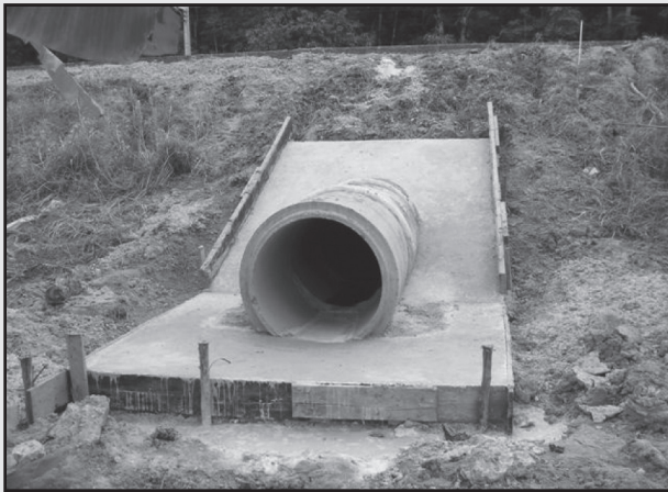
รูปที่ 5-40 กรณีแบบหล่อ (ด้านข้าง) สูงกว่าความหนาคอนกรีตที่เทอาจจะเป็นปัญหาในการปาดแต่งผิวหน้าคอนกรีต
