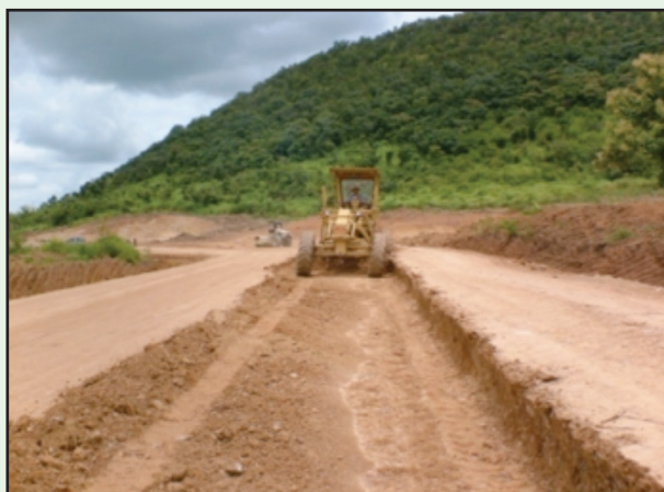
รูปที่ 4-44 ความแน่นไม่ผ่านเกณฑ์ และค่า O.M.C. ไม่อยู่ในช่วง \pm 3\% ให้รี้อแล้วบดอัดใหม่
