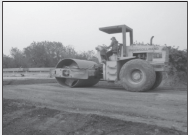
รูปที่ 4-23 การบดอัดบริเวณที่อยู่ใกล้กับโครงสร้าง คสล. ไม่ควรสันสะท้อนเนื่องจากจะทำให้โครงสร้างเสียหายได้
