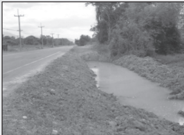
รูปที่ 4-13 บริเวณที่มีน้ำขัง ก่อนถมคันทาง ต้องสูบน้ำทิ้งและตากให้แห้ง
