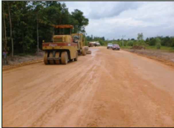
รูปที่ 4-43 ชั้นรองพื้นทางที่ความแน่นไม่ผ่านเกณฑ์ให้ทำการบดอัดใหม่
