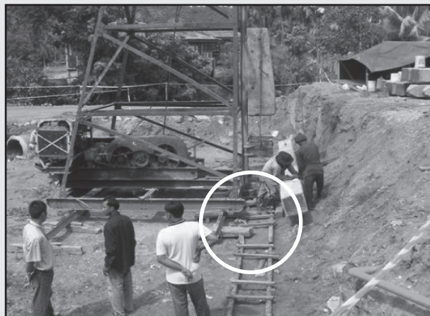
การวางปั้นจั่นบนดินอ่อนอาจล้มได้
