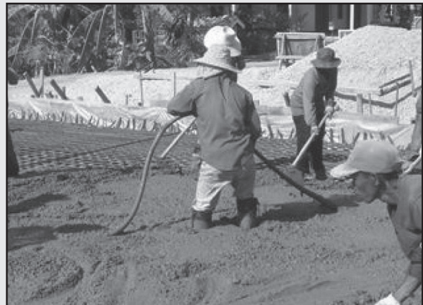
รูปที่ 5-28 (ข) การจี้คอนกรีตขณะเทคอนกรีต
